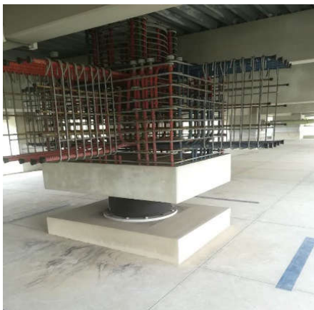
土木研究大楼隔震层
